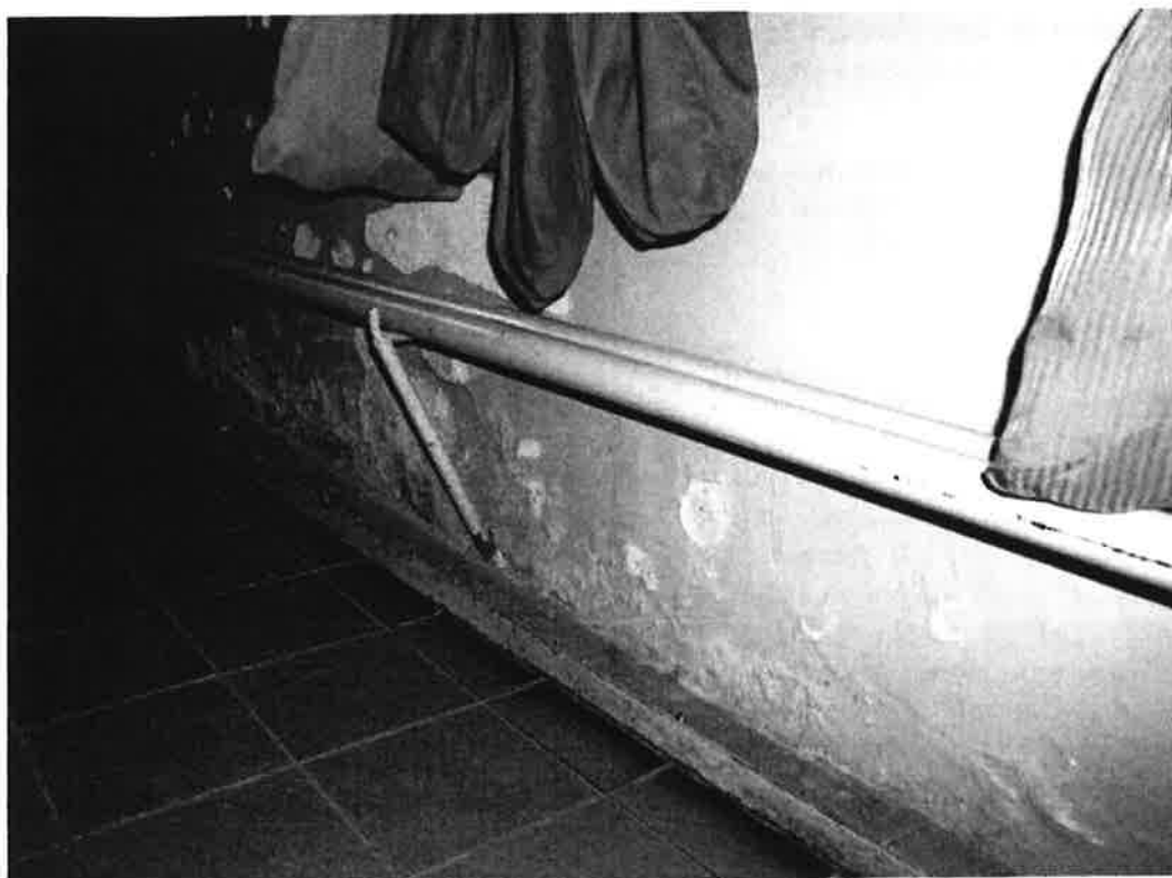
Widoczne zawilgocenie ścian piwnic.
