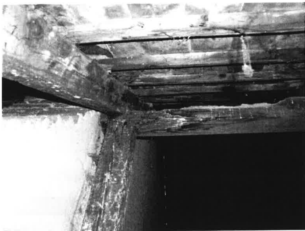
Widok węzła na połączeniu krokwi z płatwią i słupem przy kominie środkowym od strony południowej części wyższej budynku
