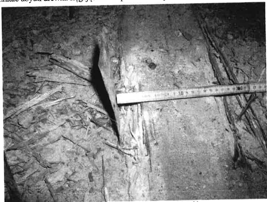
Spróchniałe ubytki belki drewnianej stropu nad poddaszem.
