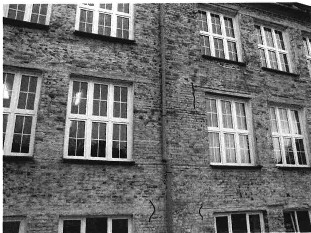
Fragment elewacji zachodniej budynku. Pogrubiono rysy
